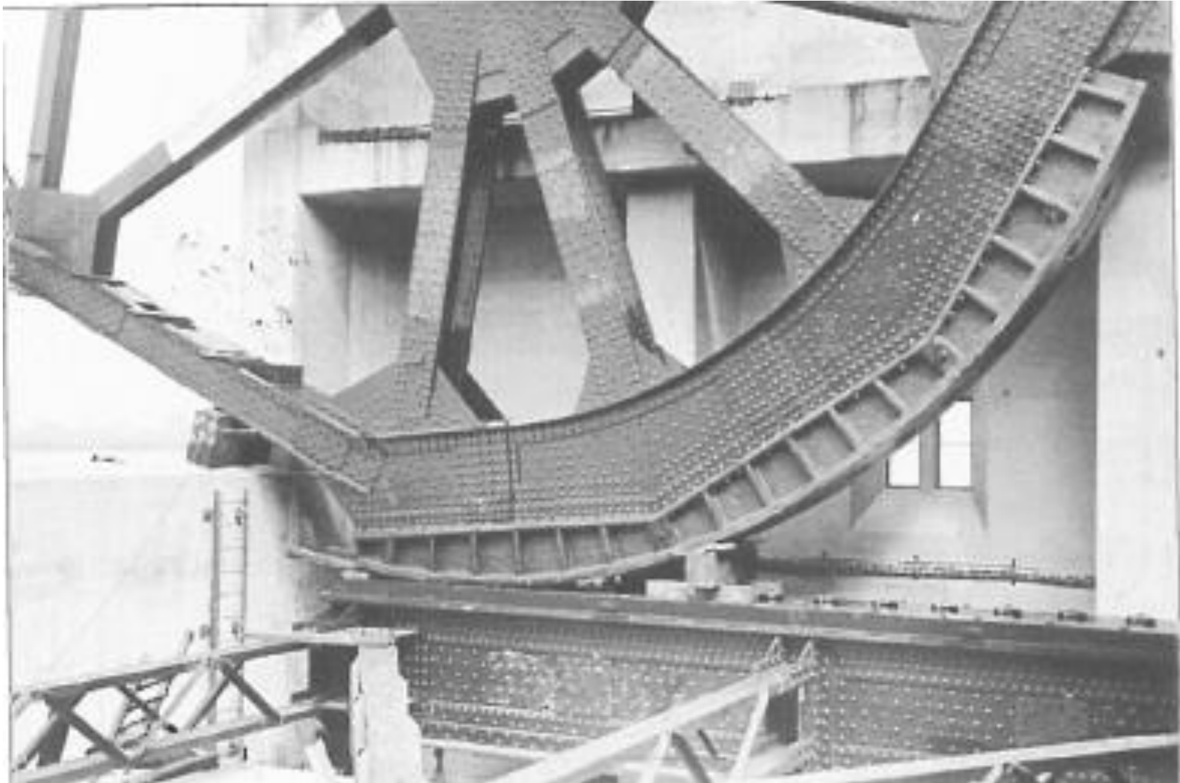
De oorspronkelijke opzet van het wiel kende geen onderlinge stabiliteitsverbanden tussen de beide liggers, zoals hier op een oude foto duidelijk zichtbaar is. Tijdens de grootschalige werkzaamheden van 1985 zijn er tussen de spaken van de wielen verbanden aangebracht van stalen profielen waardoor er minder werking tussen de beide liggers optrad. foto: J. Oosterhoff, e.a., Bruggen in Nederland 1800-1940 , p.286.
