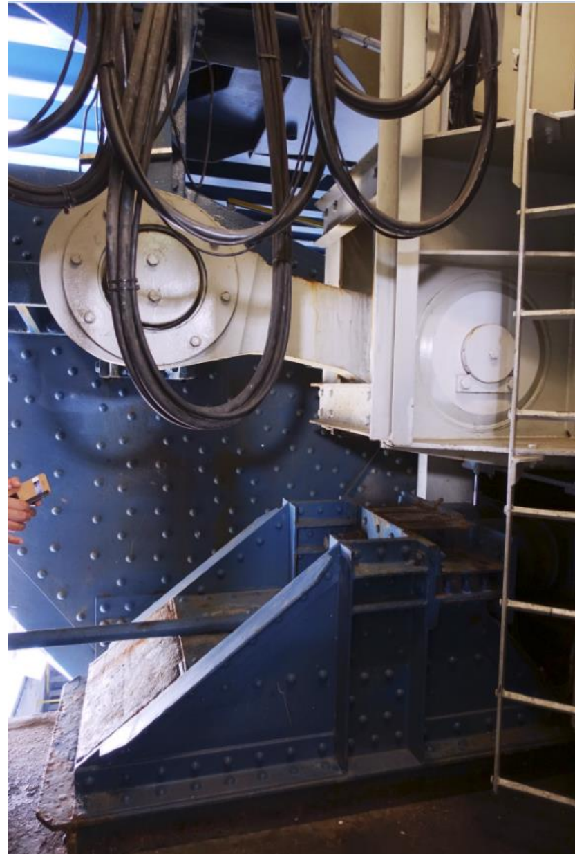
Detail van de aansluiting tussen de zuidelijke hoofdligger en de elektromotor.
