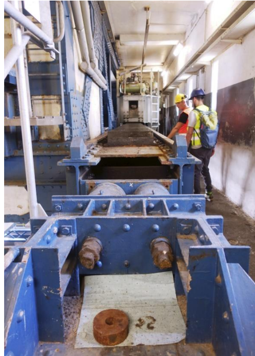
Zicht op de noordelijke elektromotor, naast het contragewicht, gezien richting het westen.
