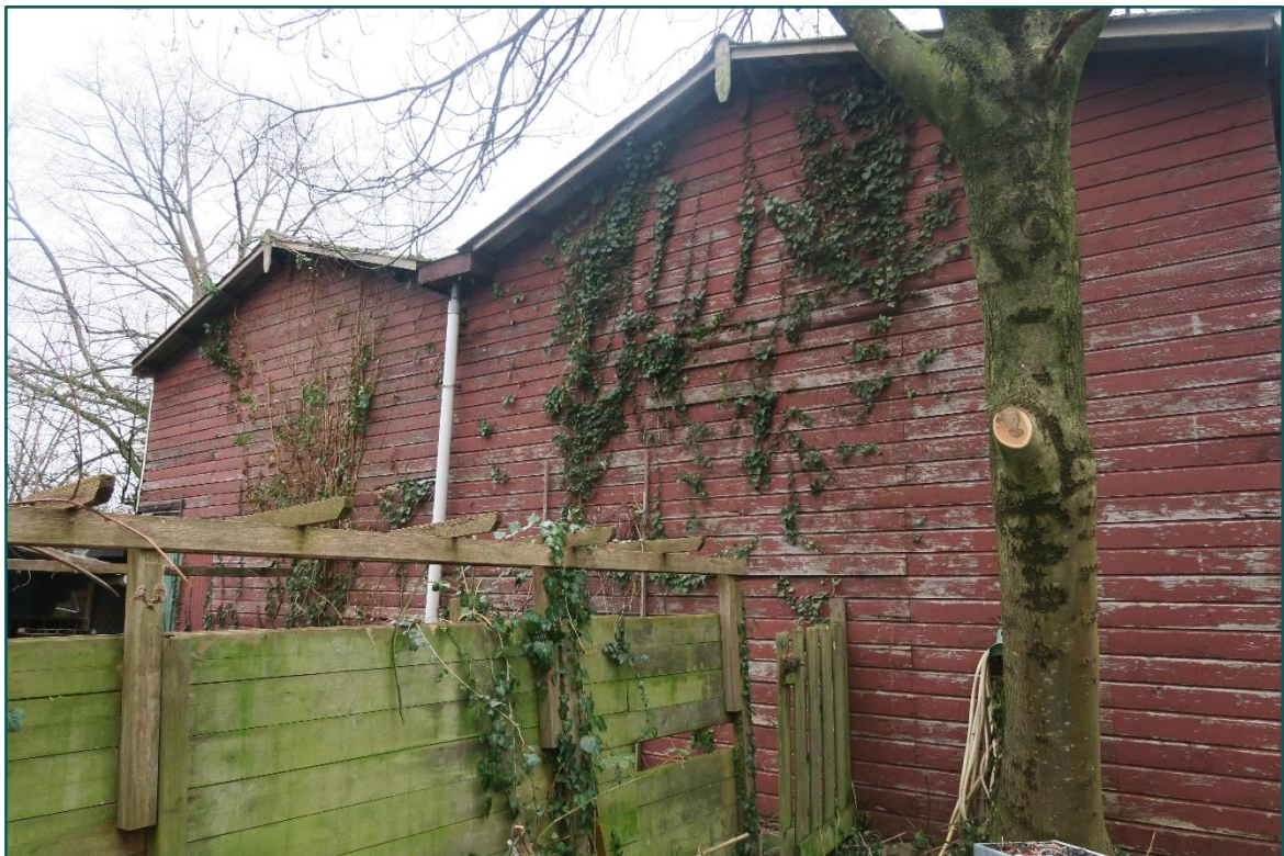
Figuur 4 Aan de achterzijde van de loods zijn meerdere planken naar buiten gekierd, echter biedt dit niet genoeg ruimte voor gebouw bewonende vleermuizen.
