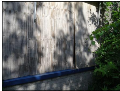
Figuur 10. Opening in de betimmering bij het raam aan zuidwestzijde van het gebouw.
