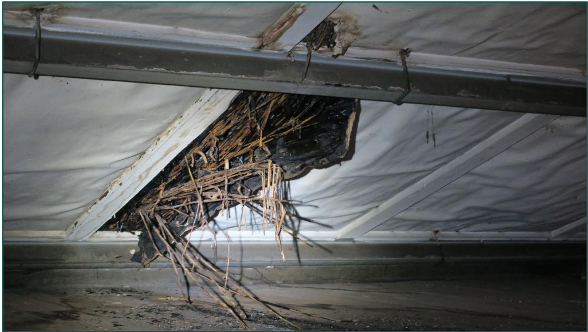
Figuur 3 Onder het dak van de loods zit een isolatie laag bestaand uit stro en teer.
