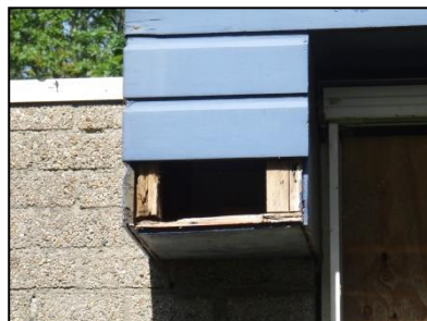
Figuur 7. Open boeiiboord door het ontbreken van de onderste plank van de betimmering.
