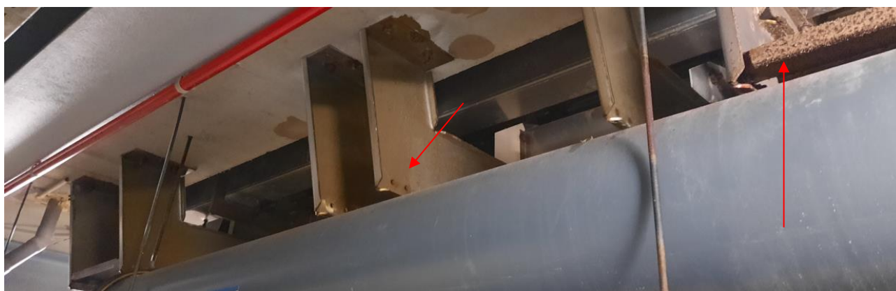
Figuur 9 - Ontbrekende koppelingen bij de steunen
