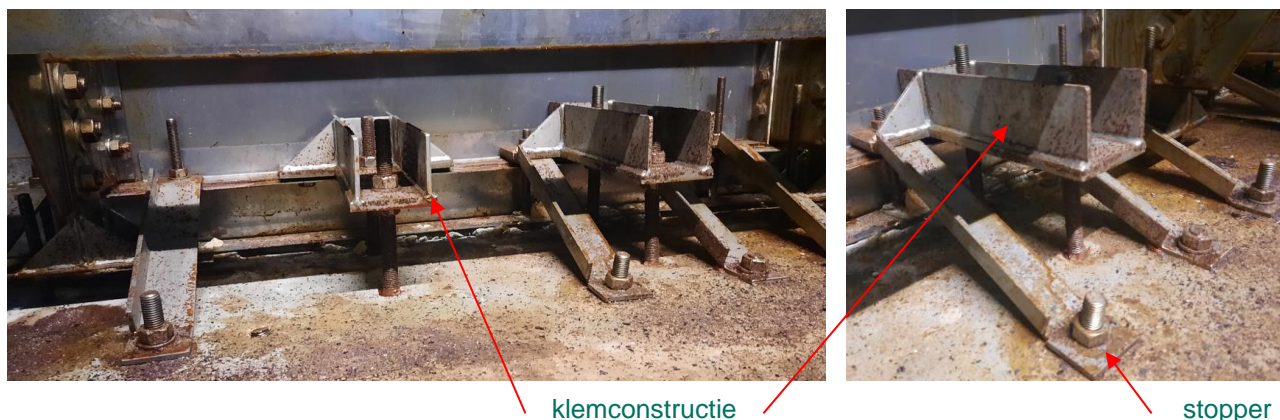
Figuur 4 - Klemconstructies die niet op tekening staan
