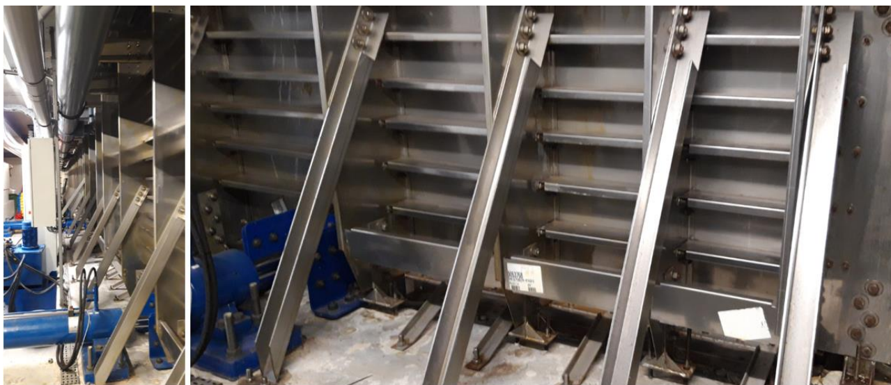
Figuur 2 - Bassinwand nabij de aandrijving van de beweegbare bodem
