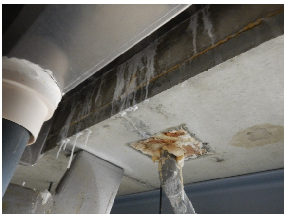
Foto 3.23: Leeksporen onderzijde 1 e verd. vloer; rondom leidingdoorvoer en aan binnenzijde vloerrand (loc. 82).
