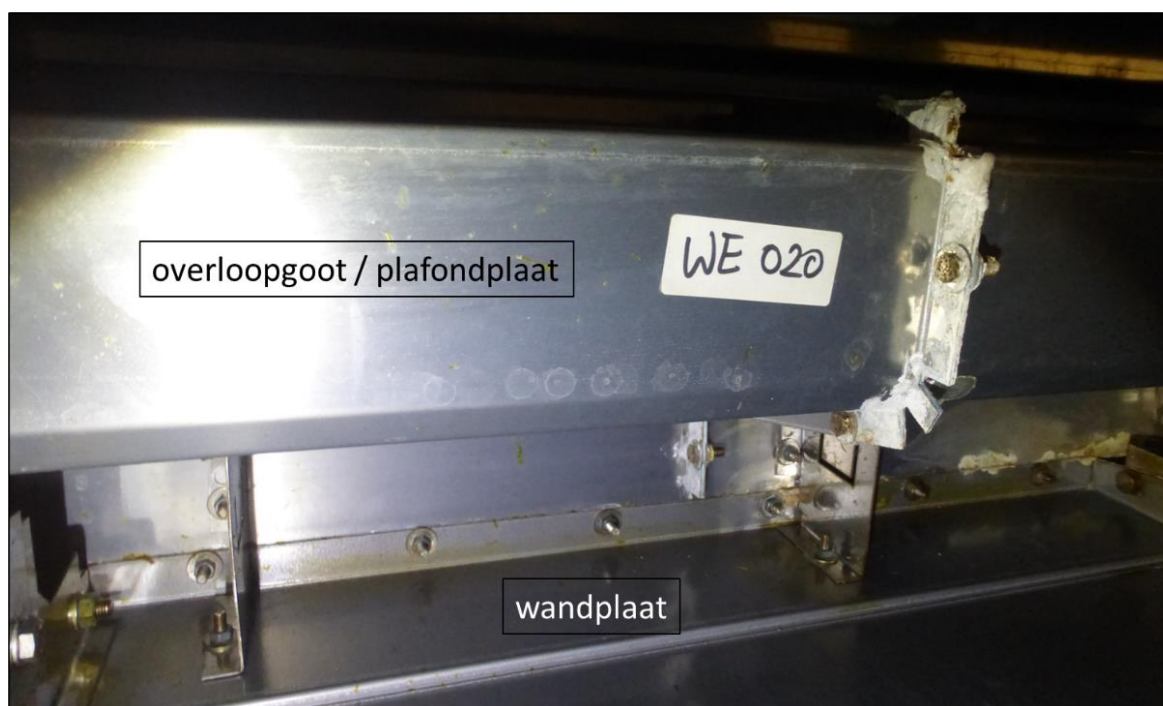
Figuur 6. Foto boven: afzettingen van zouten op de overlapverbinding tussen de zetranden van de plafondplaat en de wandplaat met leksporen naar beneden gelegen bassinwand elementen. Foto rechts: Zelfde verhaal maar op de overlapverbinding tussen twee overloopgoot-secties. (Overloop en plafond bestaan steeds uit één en dezelfde plaat.)
