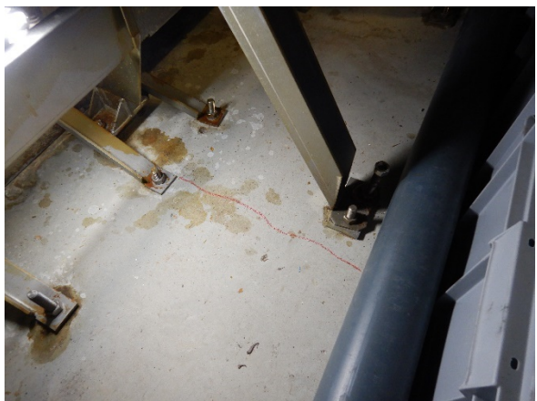
Foto 3.8: Scheur bovenzijde sloof (loc. 8).
