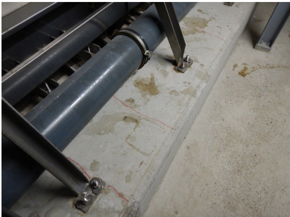
Foto 3.11: Scheur bovenzijde sloof (loc. 29); scheurwijdte 0,20 mm.
