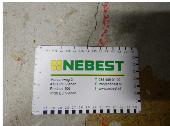
Foto 3.12: Scheur bovenzijde sloof (loc. 31); scheurwijdte 0,40 mm.
