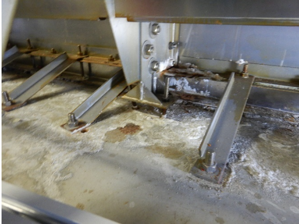
Foto 3.3: Leksproen bovenzijde sloof (loc. 1).
