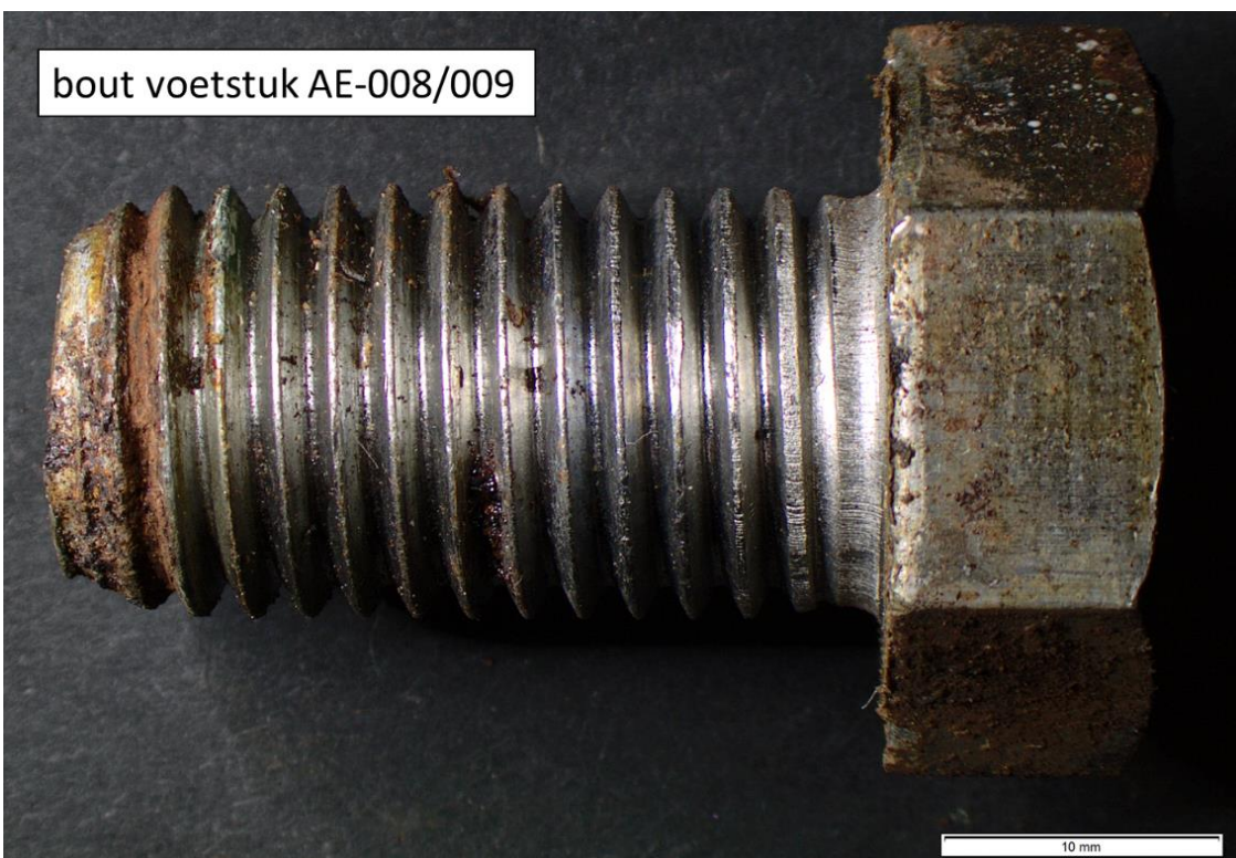
Figuur 16. Een van de bouten uit het voetstuk onder de verticale staander tussen vak AE-008 en AE-009 met voornamelijk roestafzettingen aan de blootgestelde neus en kop van de bout.
