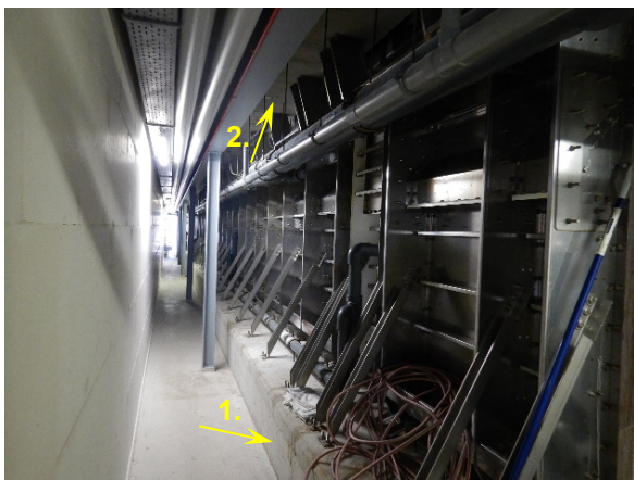
Foto 1: Overzicht installatieruimte (BG).
