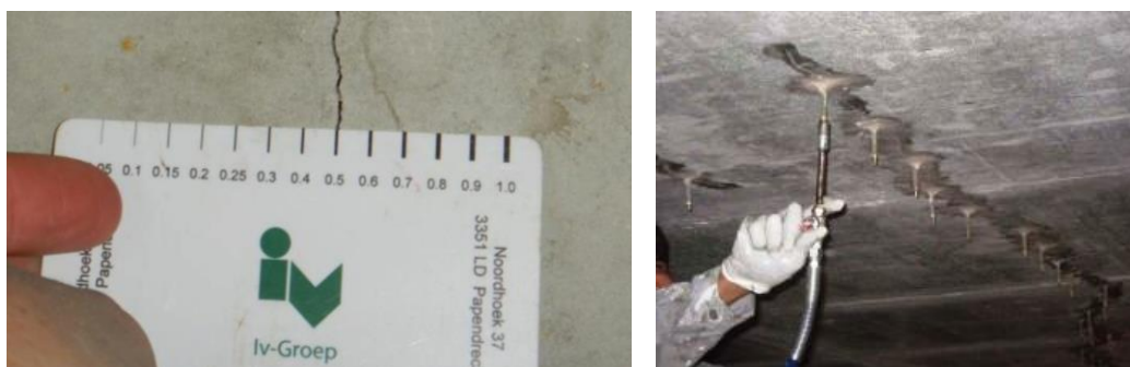
Figuur 13, scheurmeting van het zwembad tijdens een schouw én een voorbeeld van scheurinjectie
