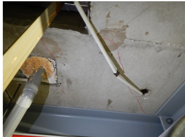
Foto 3.22: Scheur onderzijde 1 e verd. vloer; nabij hoekaansluiting (loc. 62).
