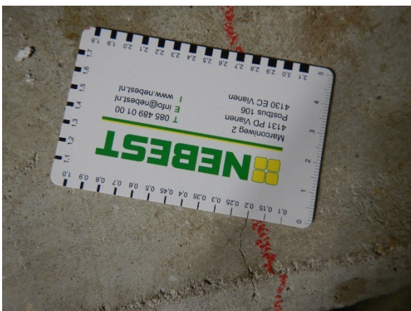
Foto 3.13: Scheur bovenzijde sloof (loc. 33); scheurwijdte 0,20 mm.
