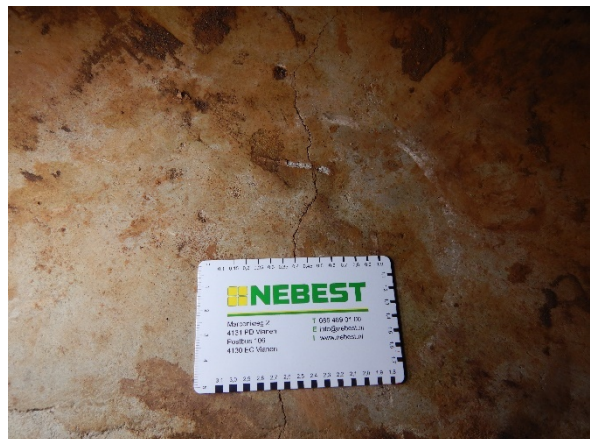
Foto 3.6: Scheur bovenzijde sloof (loc. 5); scheurwijdte 0,40 mm.
