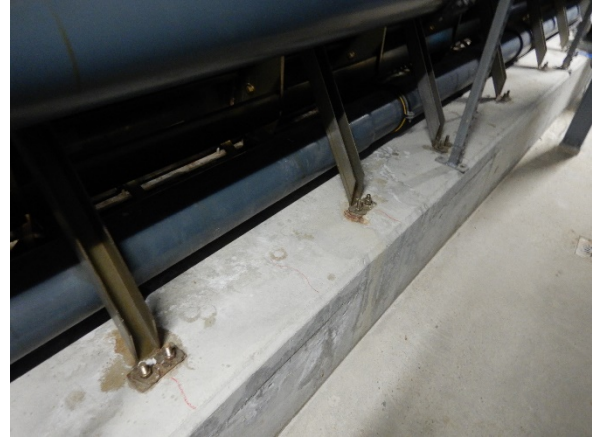
Foto 3.10: Scheur bovenzijde sloof (loc. 20); scheurwijdte 0,20 mm.
