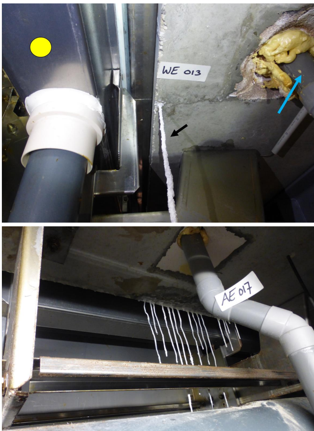
Figuur 7. Foto boven: Naast de overloopgoot lag verzonken in het beton een kleinere afvoergoot rondom het gehele bassin om 'vuil' water vanaf de loopvloer af te voeren naar het riool. De doorvoeren hiervan waren uitgevoerd in standaard PVC pijpen (hier aangeduid met blauwe pijl). Vanuit nagenoeg alle doorvoerposities waren leksporen zichtbaar van wit product waarbij deze op de laagste punten stalactieten vormden. De foto boven betreft vak WE-013. De gele stip duidt de overloopgoot aan. Foto onder: Zelfde verhaal met meerdere stalactieten in vak AE-017.
