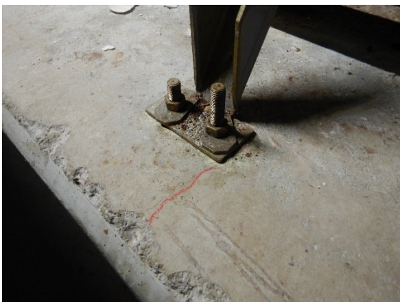
Foto 3.7: Scheur bovenzijde sloof (loc. 7); scheurwijdte < 0,20 mm.
