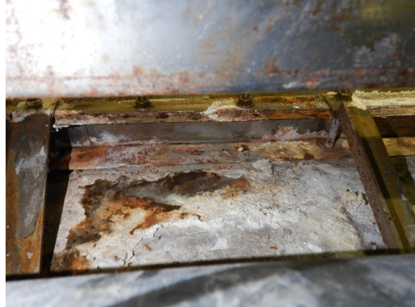
Foto 3.4: Leksproen bovenzijde sloof (loc. 53).
