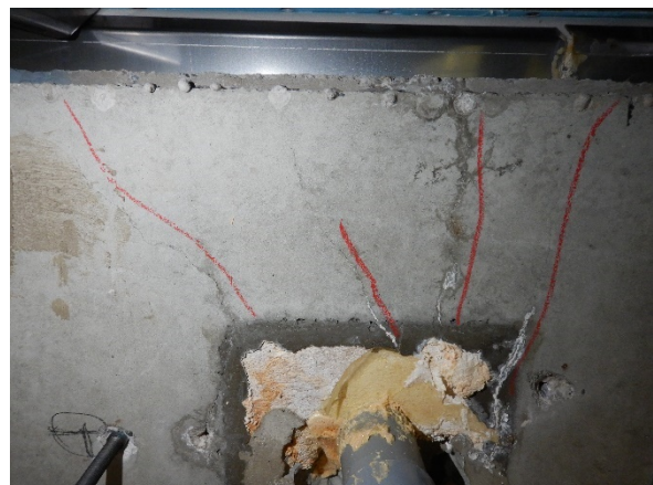
Foto 3.18: Scheuren op de onderzijde 1 e verd. vloer; krimp-scheuren rondom leidingdoorvoer (loc. 59).
