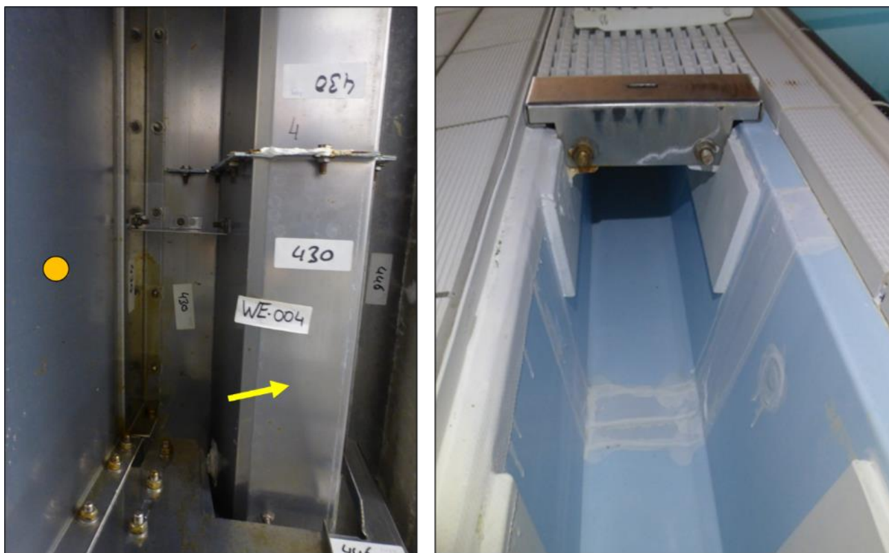
Figuur 5. Foto links: Een onderaanzicht van een deel van het plafond met daarin geïntegreerd de overloopgoot (aangegeven met gele pijl). Hier is goed te zien hoe de goot is opgebouwd uit verschillende delen die middels zetranden aan elkaar bevestigd zitten met daartussen twee lagen folie. De oranje stip geeft de wand van het bassin aan. Foto rechts: De overloopgoot van bovenaf gezien na verwijdering van het rooster. De rvs goot is aan de waterzijde geheel beplakt met folie welke ter hoogte van de zetranden aanvullend is behandeld met een afdichtend (hard) product.
