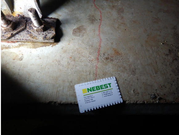
Foto 3.9: Scheur bovenzijde sloof (loc. 9); scheurwijdte 0,30 mm.
