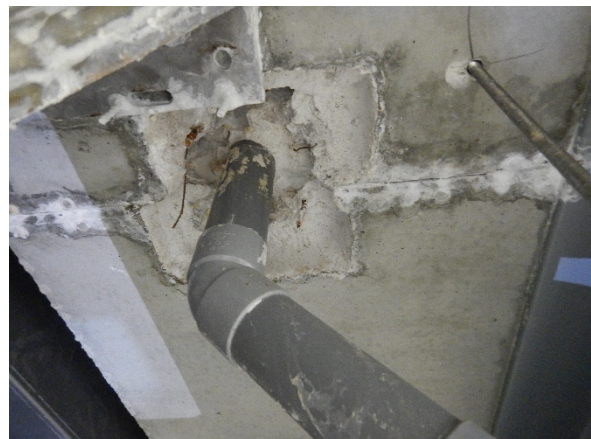
Foto 3.16: Lekkage op de onderzijde 1 e verd. vloer; rondom leidingdoorvoer (loc. 55).
