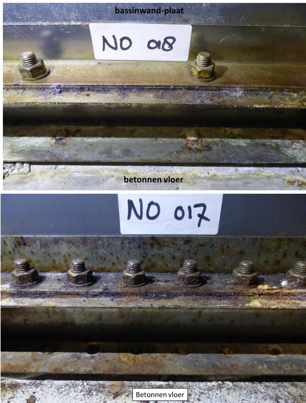
Figuur 2. Twee detailfoto's van de onderzijde van de wand met op de betonnen vloer een U-profiel met de rug naar de waterzijde. Op het profiel was de onderste zetrans van de wandplaat geplaatst met de zetrans richting technische ruimte. Boven op de zetrans was een hoeklijn geplaatst. De drie lagen (U-profiel, zetrans wandplaat, en hoekprofiel) waren op regelmatige afstanden met boutverbindingen tegen elkaar geklemd. De vakken NO-017 en 018 toonden een relatief sterke mate van productafzetting en visuele aantasting voor deze positie / dit detail wat echter in verschillende vakken het geval was.
