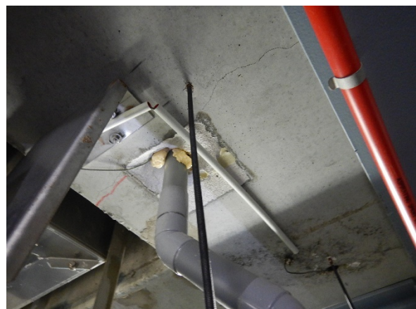
Foto 3.24: Scheur onderzijde 1 e verd. vloer; loodrecht op vloerrand; langs leidingdoorvoer (loc. 67).
