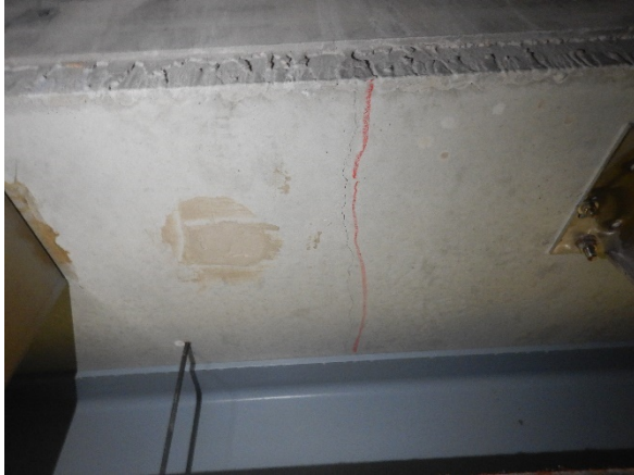
Foto 3.25: Scheur onderzijde 1 e verd. vloer; loodrecht op vloerrand (loc. 73).
