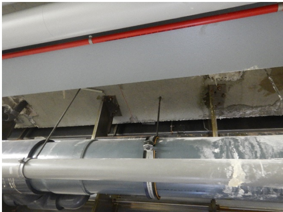
Foto 3.21: Scheur en leeksporen onderzijde 1 e verd. vloer; loodrecht op vloerrand (loc. 84).
