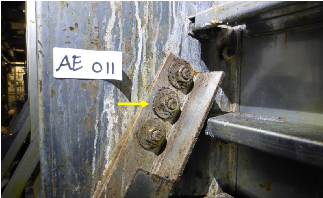
Figuur 15. De middelste bout van de bevestiging van de schuine schoor aan de verticale staander tussen vak AE-010 en vak -011 is losgemaakt en meegenomen naar het laboratorium. (Hier nog in positie.)
