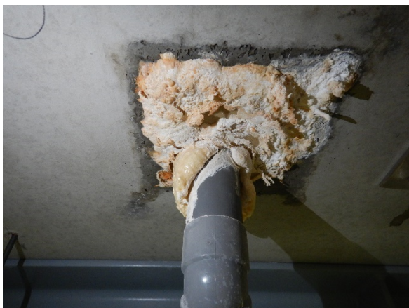
Foto 3.17: Lekkage op de onderzijde 1 e verd. vloer; rondom leidingdoorvoer (loc. 57).
