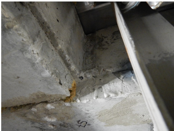
Foto 3.27: Scheur onderzijde 1 e verd. vloer; nabij hoekaansluiting; loopt door in vloerrand (loc. 68).
