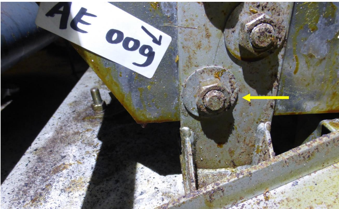
Figuur 11. De hier nog te verwijderen onderste bout van het voetstuk onder de verticale staander/rib tussen vak AE-008 en AE-009
