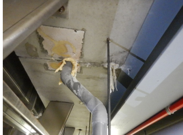
Foto 3.20: Leeksporen onderzijde 1 e verd. vloer; rondom leidingdoorvoer (loc. 79).
