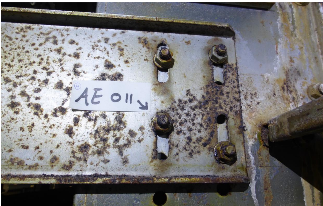
Figuur 14. Eén van de bouten waarmee de support naar het betonnen plafond aan de verticale staander bevestigd zat tussen vak AE-010 en AE-011 is uitgehaald en meegenomen naar het laboratorium.
