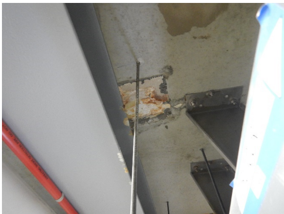
Foto 3.15: Lekkage op de onderzijde 1 e verd. vloer; vanuit aansluitranden betonreparatie (loc. 54).
