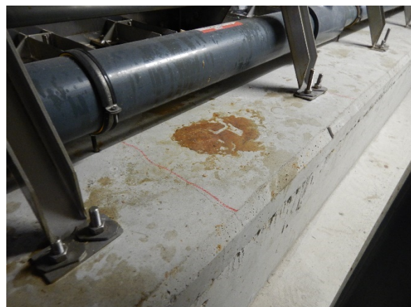
Foto 3.14: Scheur bovenzijde sloof (loc. 37); scheurwijdte 0,50 mm.
