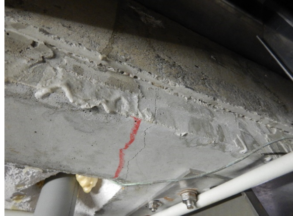
Foto 3.26: Scheur onderzijde 1 e verd. vloer; nabij hoekaansluiting; loopt door in vloerrand (loc. 76).
