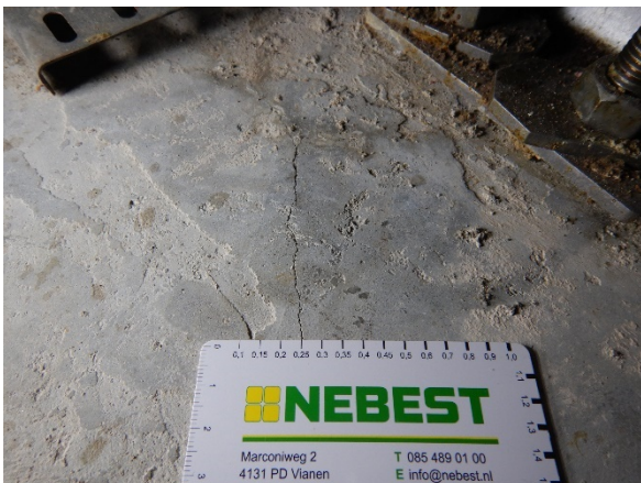
Foto 3.5: Scheur bovenzijde sloof (loc. 4); scheurwijdte 0,25 mm.
