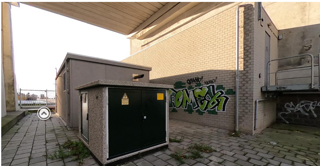
FOTO 3: TECHNISCHE RUIMTE, TRANSFORMATORSTATION, NSA RUIMTE
