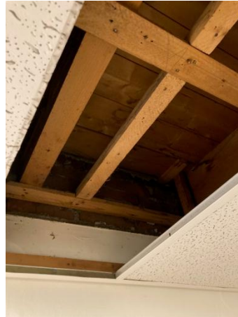
Lelsstraat 2 (oude Art Deco plafond aanslag zichtbaar)
